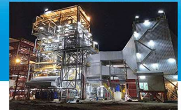
7 150 ton Bagasse Boiler
